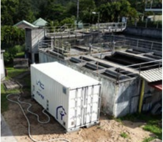
Installation d'UnYo® en Guadeloupe
